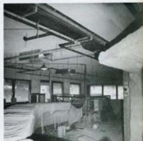
Station de production d'air froid et son « couloir »
